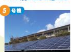
5号機 保健福祉ゾーン方面(小瀬町) 2021年11月完成 太陽電池総容量 80.0kW
