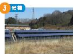
3号機 保健福祉ゾーン方面(小瀬町) 2016年2月完成 太陽電池総容量 56.0kW
